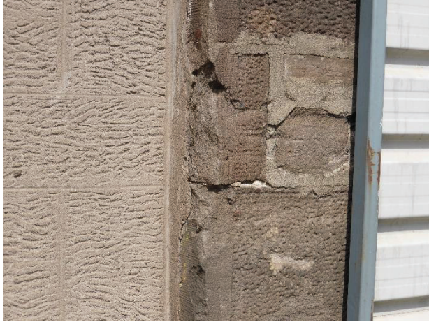
221 Cracked lintel + rylats
