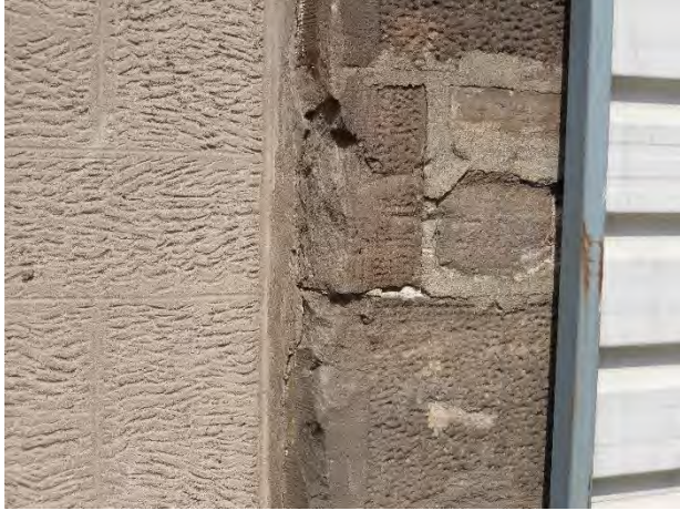
221 Cracked lintel + rylats
